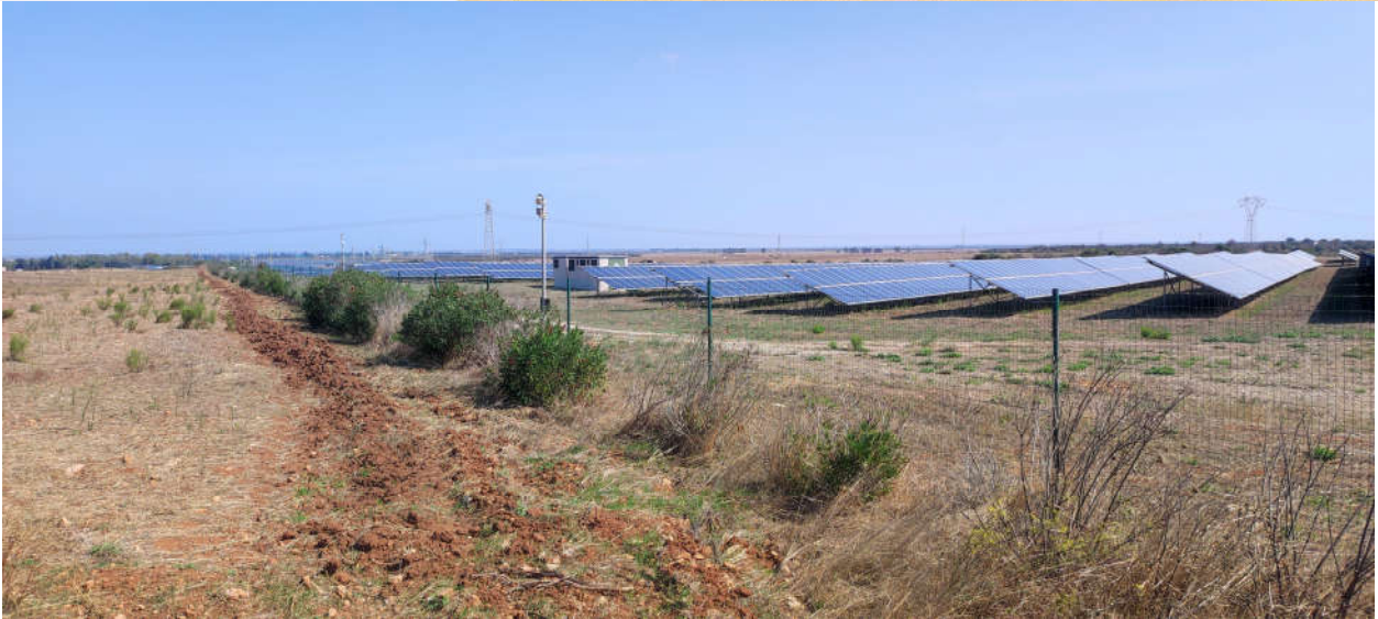
IMPIANTO SOLARE TERMICO | n. 41 impianti con una superficie solare lorda di 166,35 mq
